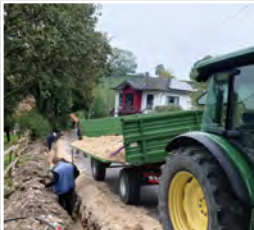
Trinkwasserversorgung Blockhütte Verkehrsve- rein Grundsteinheim
